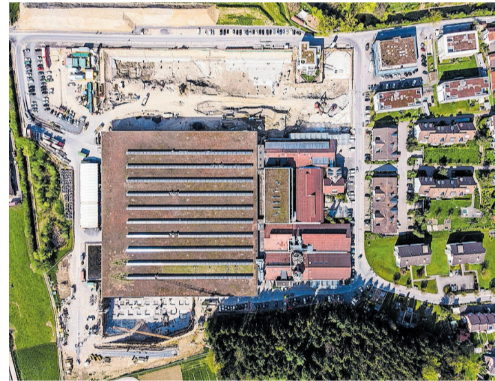
Die Bauarbeiten im Süden und Norden der bestehenden Liegenschaft sind derzeit in vollem Gang, wie man auf diesem Drohnenbild sehen kann.
