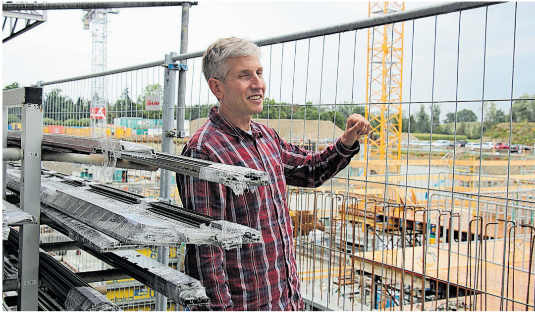
Firmenchef Stefan Baumgartner zeigt auf die Baugrube, wo der Erweiterungsbau der Fensterfabrik in Hagendorn entsteht.
